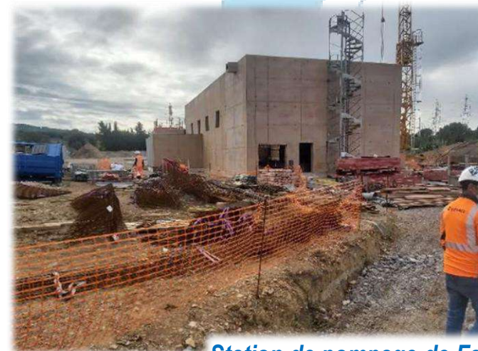
Station de pompage de Fabrègues
